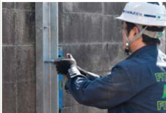
●敷地側アンクル支柱をセット 角根丸頭ボルトを敷地側から締め付けて固定
