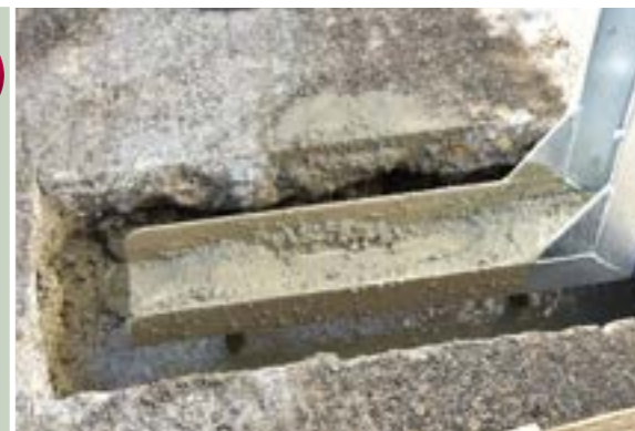
●ロックボルト(パワースレッド)と専用ナットが 固定されている事を確認
